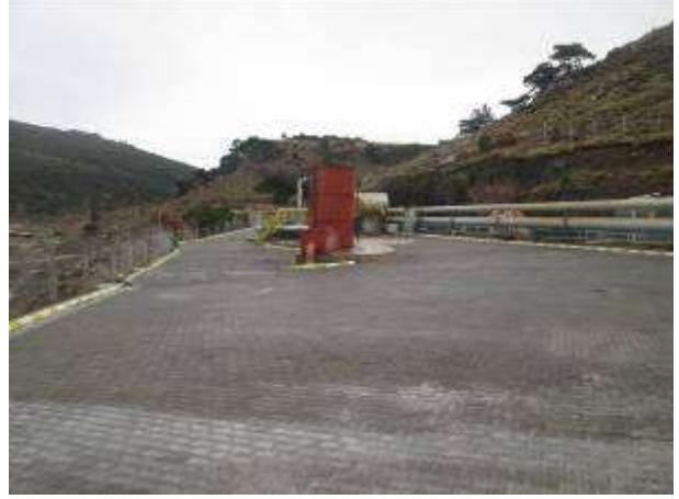
Boru Hattı ve Re-Enjeksiyon Pompası 1
