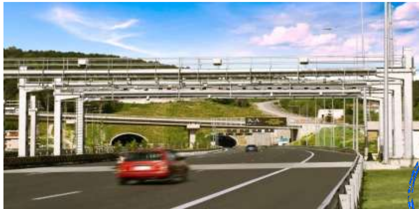
Çok Şeritli Serbest Geçiş Ücret Toplama Sistemi
